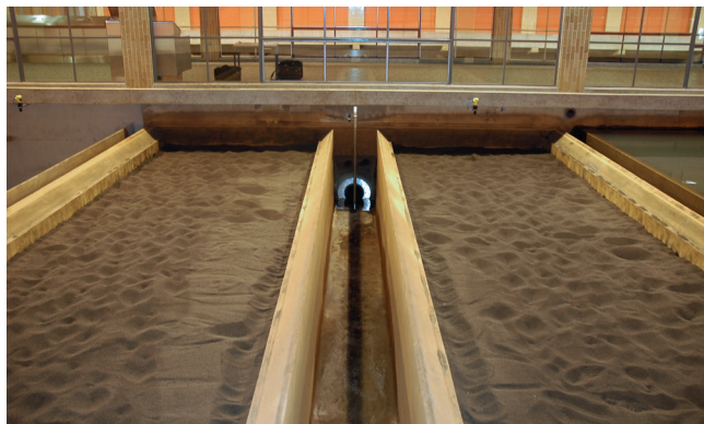
Filterbecken außer Betrieb – Filterbecken mit Filterkies
