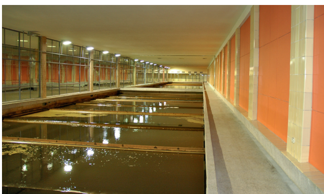
Gefülltes Filterbecken – nach dem Füllen des Filterbeckens wird das Rohrleitungssystem auf Dichtheit geprüft
